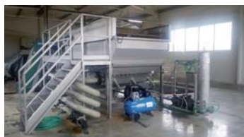
Obr. 1: Pohled na instalovanou flotační jednotku
