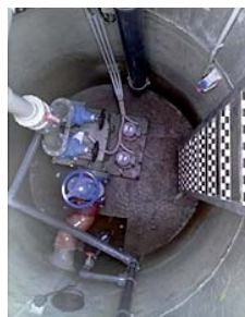
Technologické vystrojení ČS01.3
