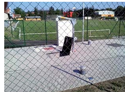
Celkový pohled na ČS01
