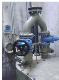
Technologické vystrojení ČS01
